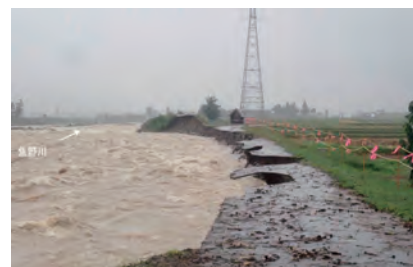
南魚沼市 信濃川水系魚野川堤防の損壊
