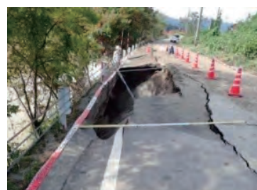
阿賀町 阿賀野川の増水により川側ブロック積基礎からの土砂の吸出しにより道路が欠壊
